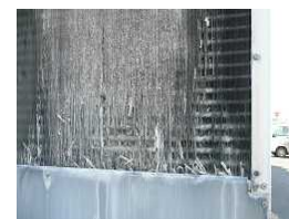
室外機の腐食
