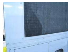
室外機の油にじみ
