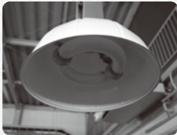
省エネに威力を発揮するLVD照明
